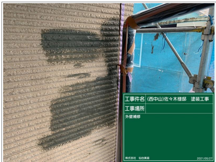
西中山 佐々木様邸 塗装工事 外壁凍害箇所 カチオン補修
