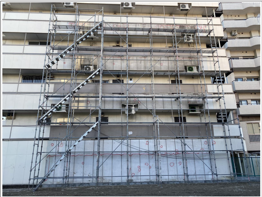
補修箇所 マーキング
