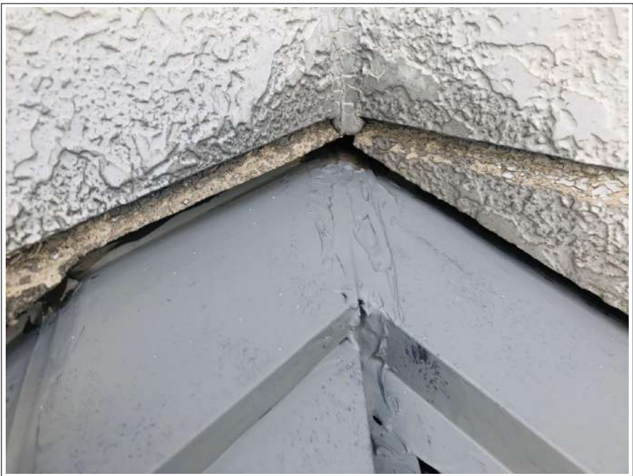
クラック補修前
