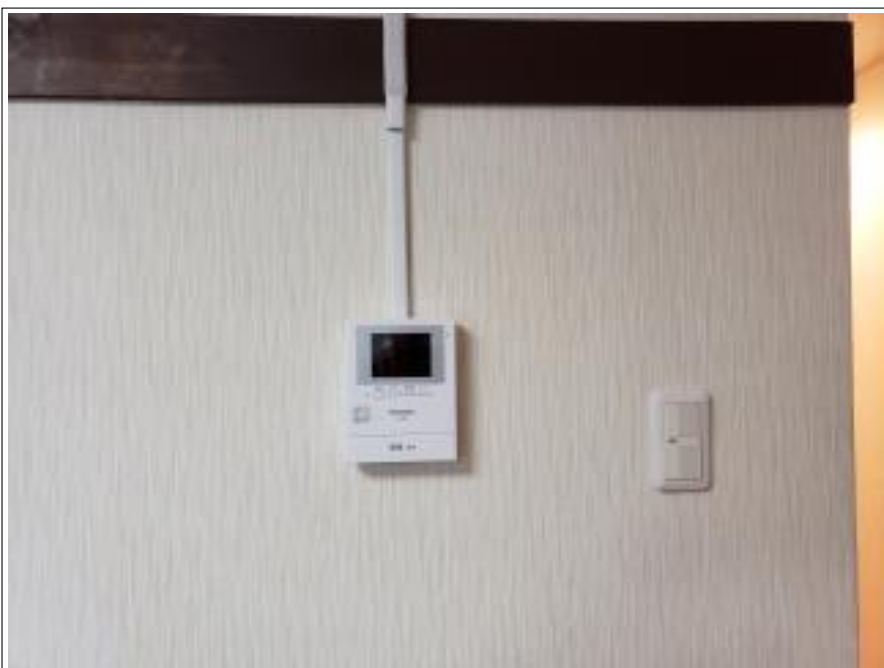
TVモニターホン新設
