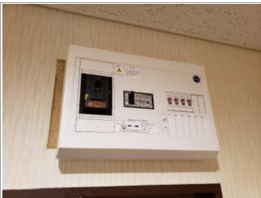
分電盤 交換後
