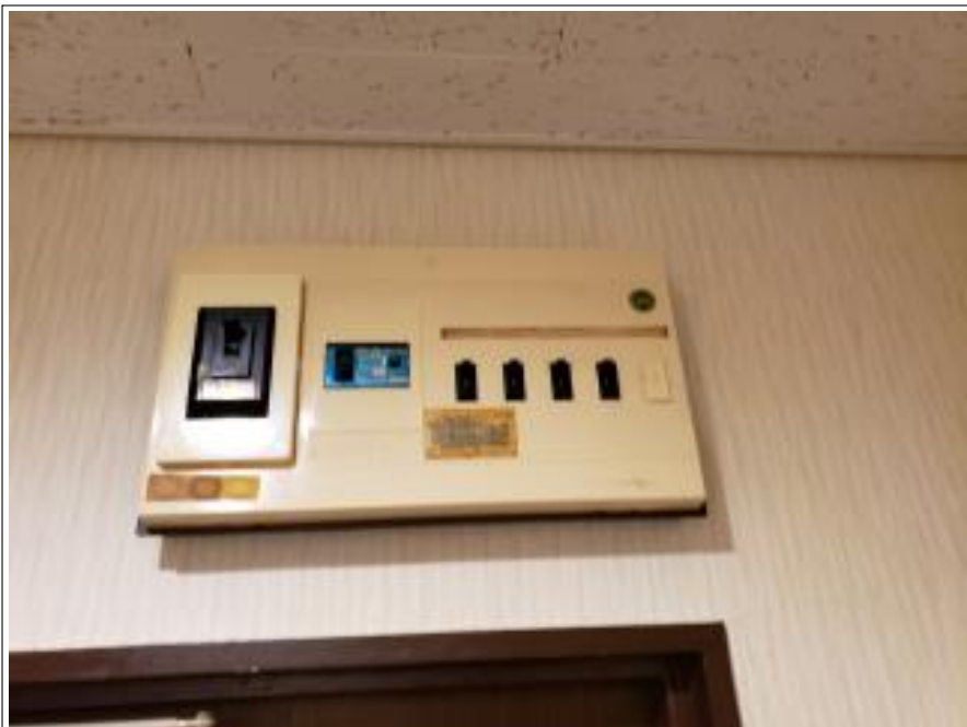
分電盤 交換前
